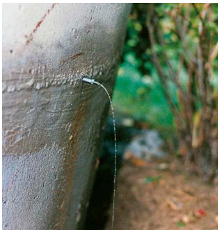
Drückendes Wasser in der Fuge
