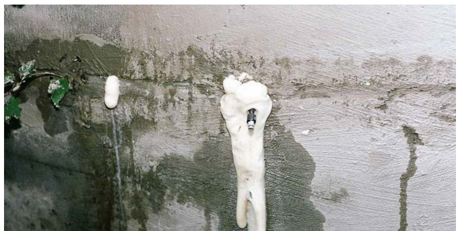
Nach dem Verpressen mit Intectin-Blitz. Der Wasserabfluss wurde in kürzester Zeit gestoppt.
